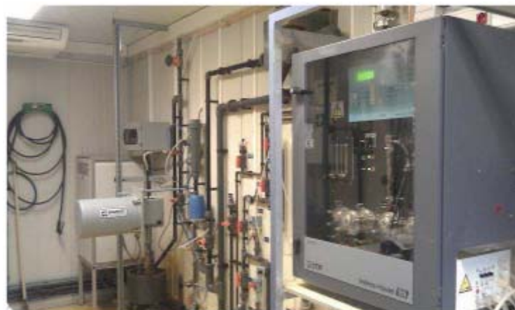
Vue intérieure de la cabine
