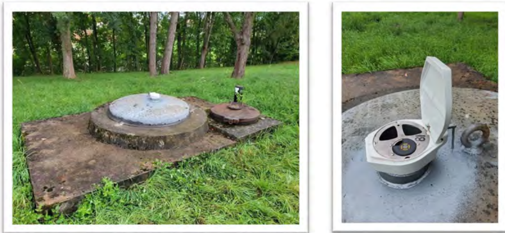
Nouvel équipement sécurisé du point RCS à Griesheim-près-Molsheim
