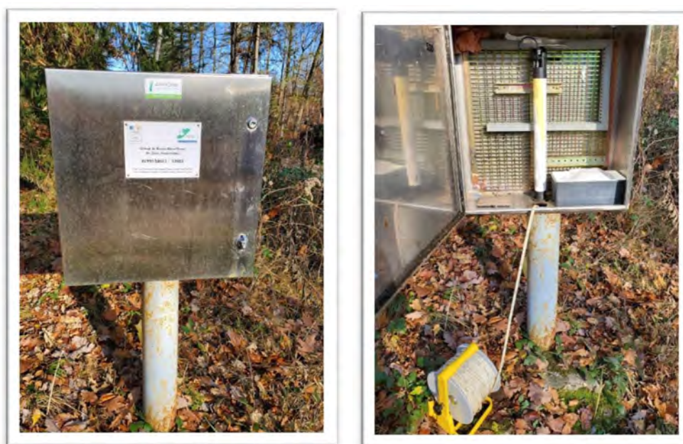
Centrale Ecolog 1000 sur le point RCS à Haguenau
