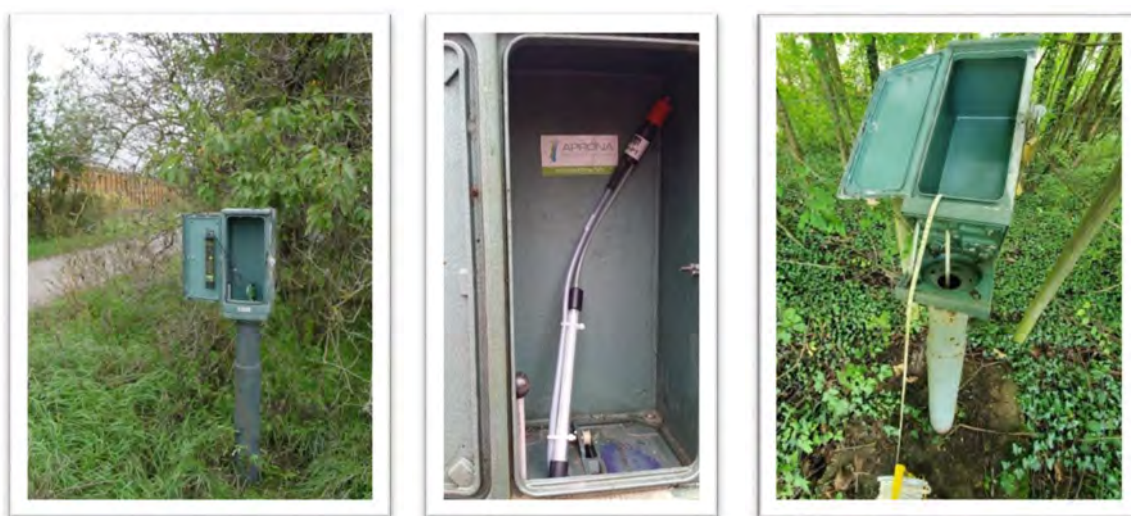
Centrale OTT Thalimèdes et SEBA Dipper PT remplacées par centrale OTT Orphéus-mini (mesure niveau + température) dans boîtier historique (anciennement piézographe)
