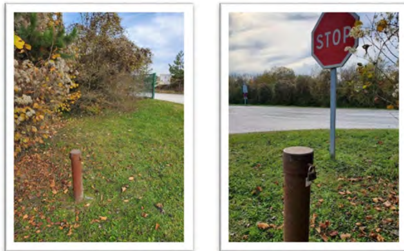
Point équipé d'une centrale télétransmise dans le tubage avec fermeture sécurisée à Lauterbourg
