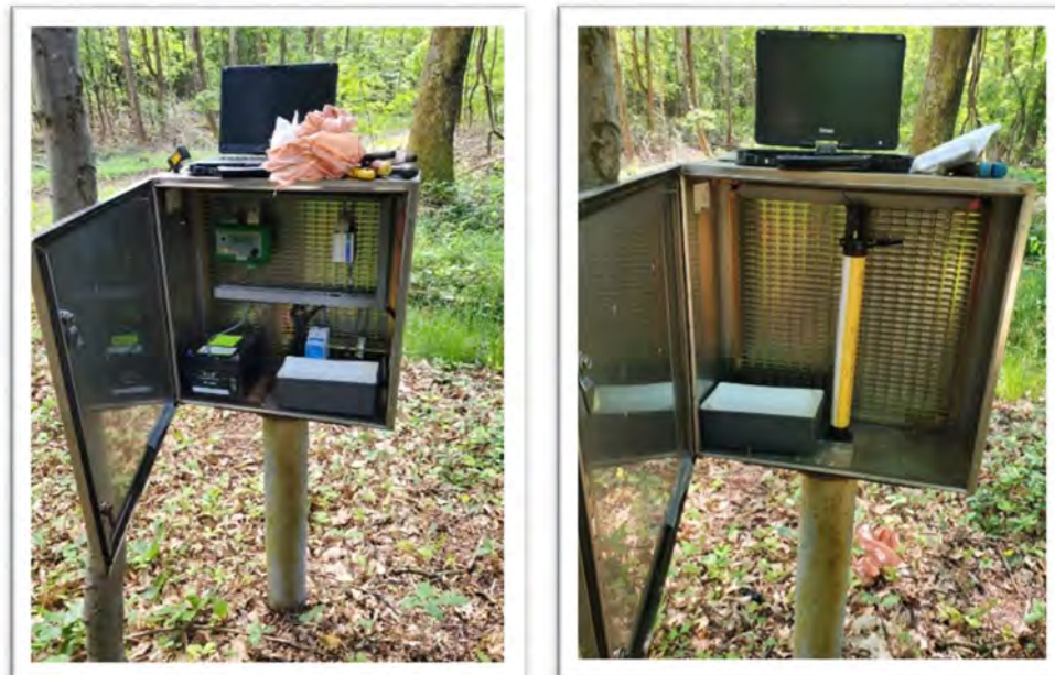
Etat avant et après modification des équipements sur le point RCS à Weitbruch
