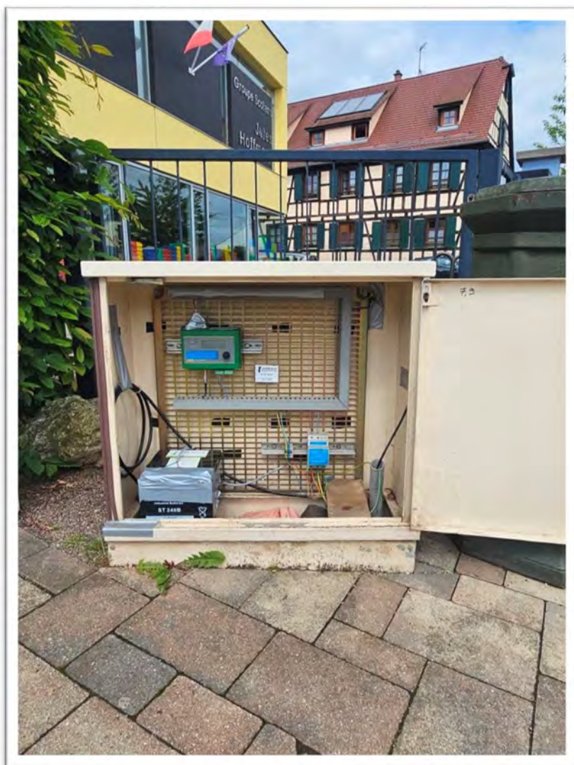
Boîtier centrale de mesures point RCS à Lipsheim
