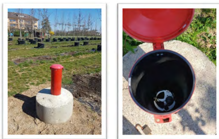
Ouvrage télétransmis du réseau APRONA à Rouffach
