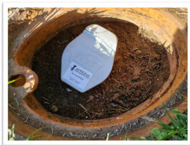
Centrale Orphéus-mini sous un hydrant avec tête OTT à Strasbourg (Pourtales)
