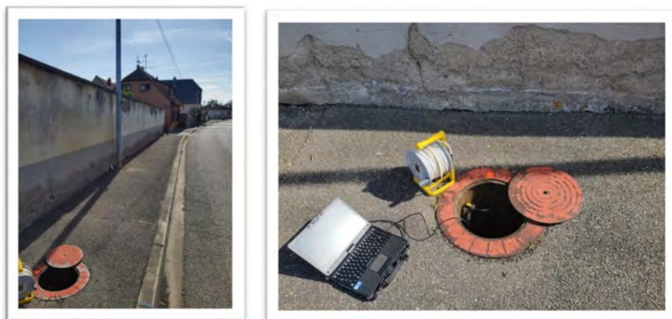
Installation centrale OTT Orphéus-mini dans puits incendie à Niederhergheim
