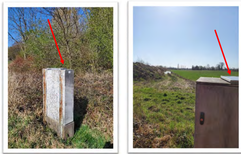
Abri renfermant les équipements + panneau solaire à Sessenheim
