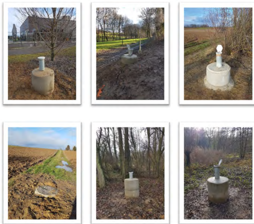
6 piézomètres réalisés (2018) et équipés depuis 2019 pour le suivi du secteur du Kabis
