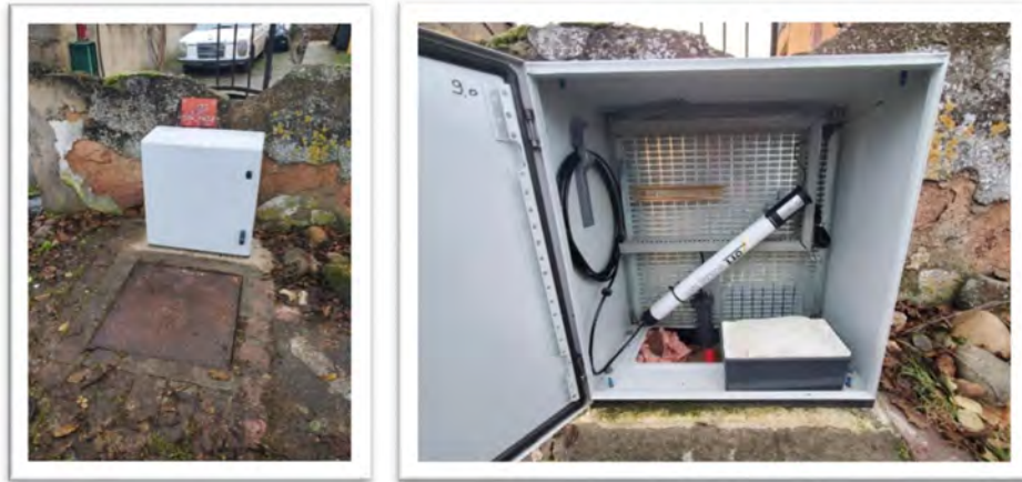
Coffret sécurisé et centrale Ecolog 1000 sur point à Guémar
