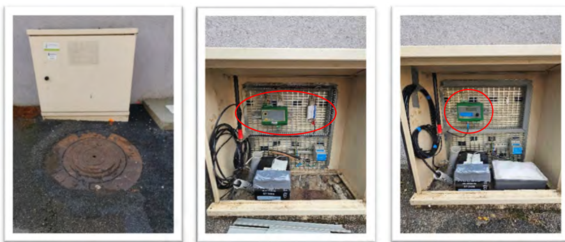
Boîtier abritant la centrale télétransmise et Remplacement du modèle OTT Duosens par NetDL 500 à Hettenschlag
