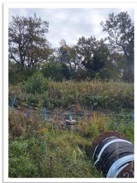
Centrale Orphéus-mini sous un hydrant avec tête OTT à Strasbourg (Pourtalès)
