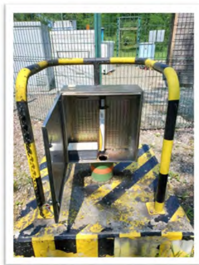
Centrale Ecolog 500 télétransmise en place à Fessenheim (RCS)
