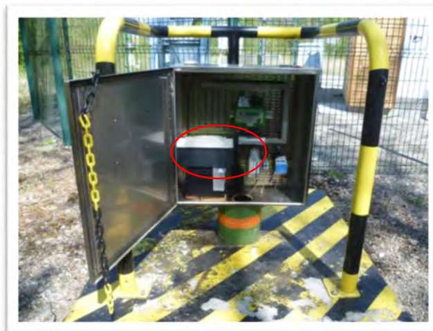
Site télétransmis de Fessenheim (RCS) avec filtre dessicant et bac de récupération
