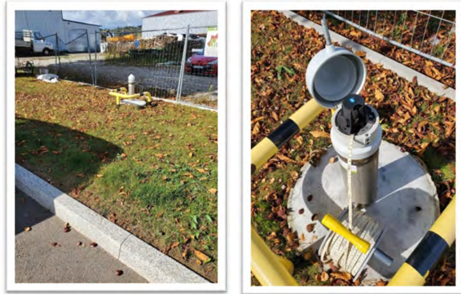
Tête spécifique avec arceau de protection sur point RCS à Habsheim
