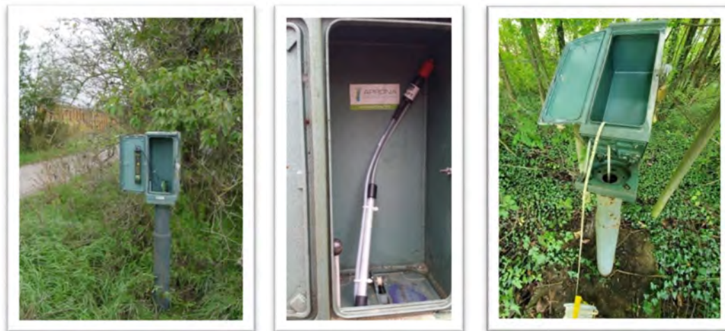
Centrale OTT Thalimèdes et SEBA Dipper PT remplacées par centrale OTT Orphéus-mini (mesure niveau + température) dans boîtier historique (anciennement piézographe)
