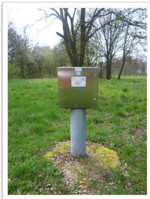
Centrale Ecolog 500 télétransmise dans boîtier à Wittenheim
