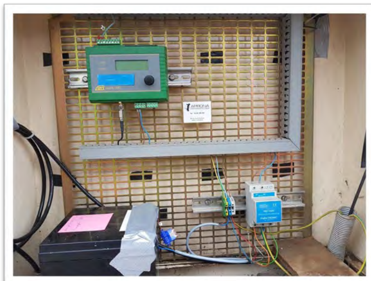
Centrale OTT NetDL 500 avec modem intégré à Lipsheim
