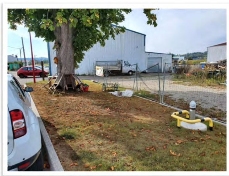
FIGURE 22 : ETAT FINAL DU NOUVEAU FORAGE A HABSHEIM
