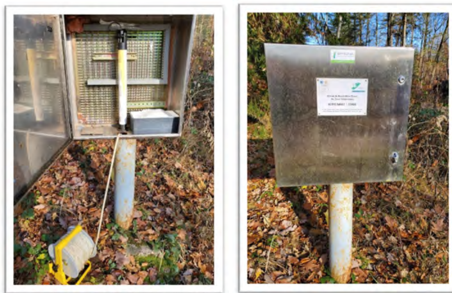
FIGURE 8 : CENTRALE ECOLOG 1000 SUR LE POINT RCS A HAGUENAU
