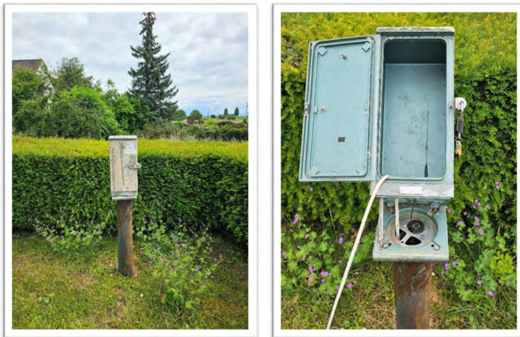
FIGURE 18 : CENTRALE ECOLOG 500 TELETRANSMISE ET MESURE VIA SOCLE BOITIER A LAMPERTHEIM
