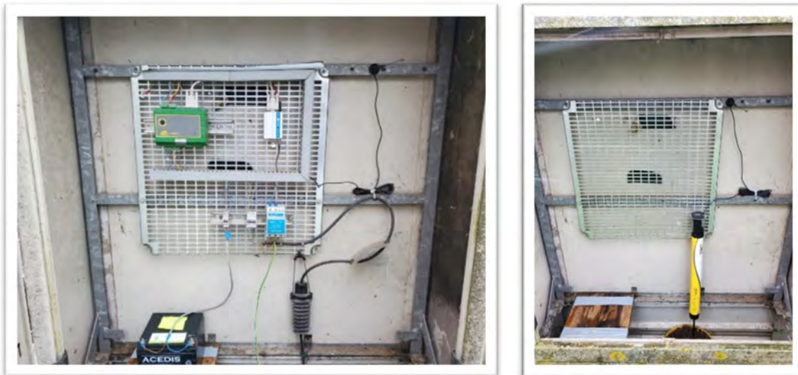
FIGURE 16 : CENTRALE DUOSENS + MODEM GSM + SONDE PRESSION REMPLACES PAR CENTRALE ECOLOG 500 A CERNAY
