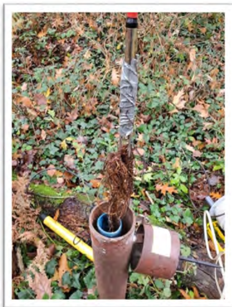
FIGURE 1 : RACINES DANS TUBAGE INTERIEUR PVC A WISSEMBOURG
