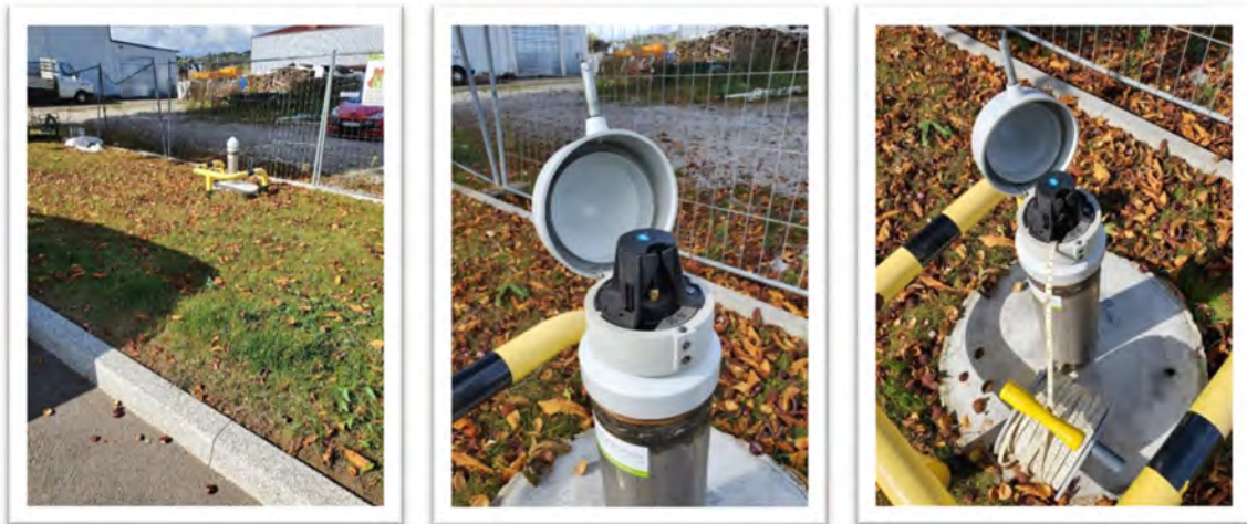
FIGURE 13 : TETE SPECIFIQUE AVEC ARCEAU DE PROTECTION SUR POINT RCS A HABSHEIM
