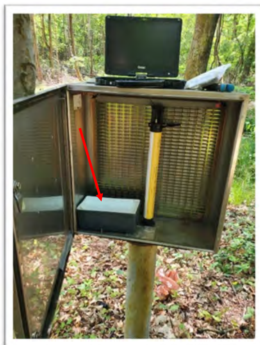
FIGURE 4 : BOITIER AVEC ECOLOG 500 ET FILTRE DESSICANT SUR LE POINT RCS A WEITBRUCH
