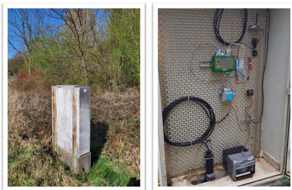
FIGURE 3 : EXTERIEUR (PANNEAU SOLAIRE) ET INTERIEUR DU BOITIER A SESSENHEIM
