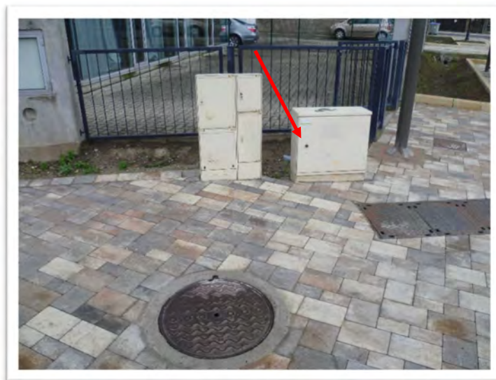
FIGURE 5 : BOITIER ABRITANT LA CENTRALE DE MESURES A LIPSHEIM
