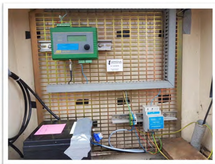
FIGURE 6 : CENTRALE OTT NETDL 500 AVEC MODEM INTEGRE A LIPSHEIM
