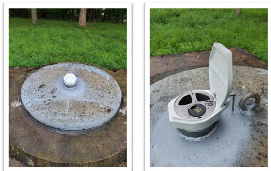
FIGURE 10 : TETE PIEZO OTT ET ECOLOG 500 SUR LE POINT DE GRIESHEIM-PRES-MOLSHEIM
