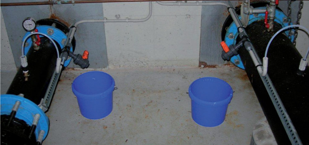
La station de chloration du SMPEP de la Hardt
