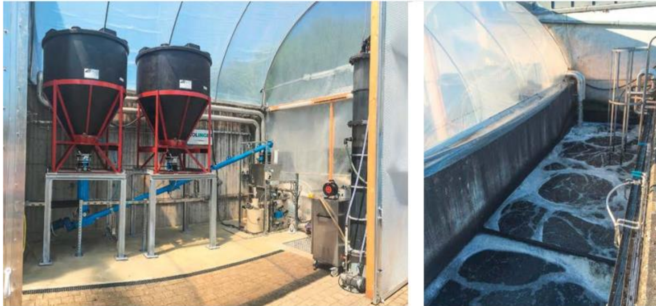
Figure 14. Dispositifs de stockage et de dosage du CAP (à gauche) et zone 1 du réacteur de floculation (à droite). (Löwenberg et al., 2016)
